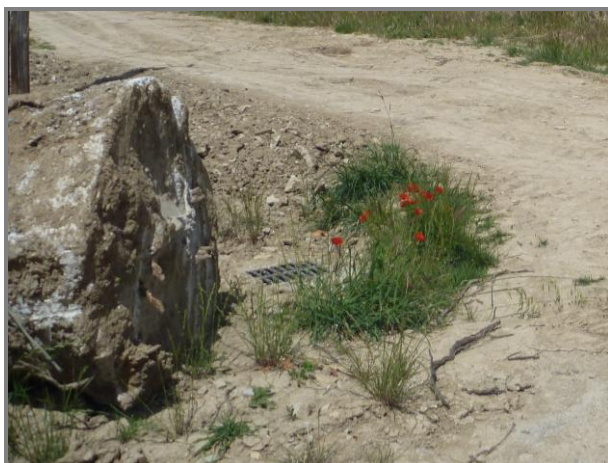
Figure 28 : Mauvais positionnement d'une grille de collecte (exemple sur le nouveau réseau secteur Le Clos / les Drailles)
